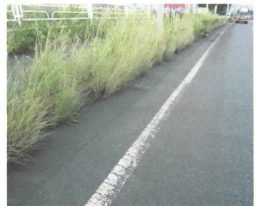
草が繁茂した国道の路側
