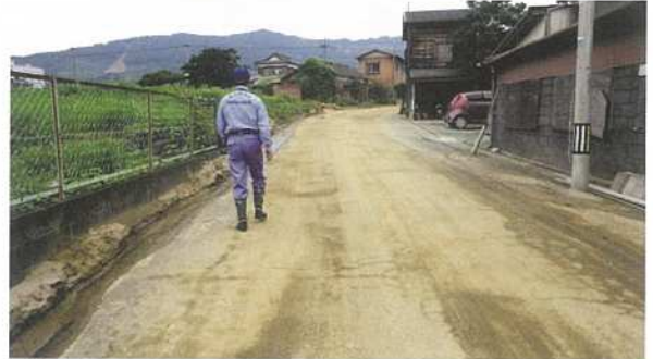
出水で道路に流出し堆積した土砂
